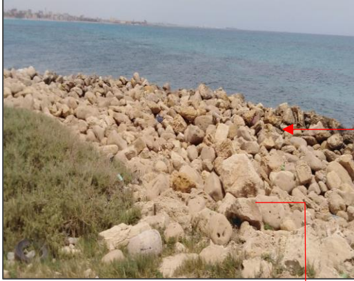
الصورة (149) ب-أحجار بناء مفككة
